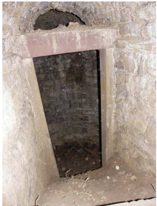
Au bout de la galerie d'accès, l'entrée en pierre de taille donnant dans la glacière.
